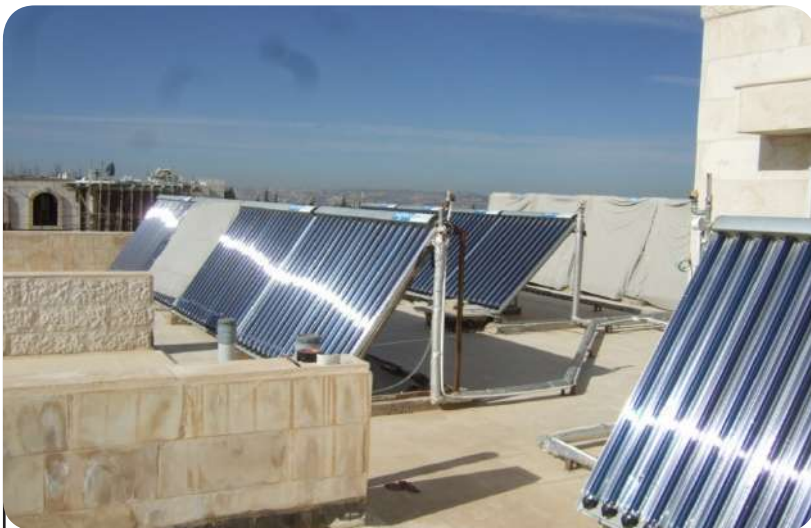
(١٤) سخانات مياه شمسية من الأنابيب المفرغة
